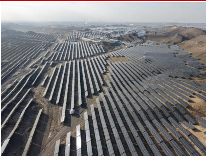
图 17：中国大唐中卫云基地 50 万千瓦光伏电站
