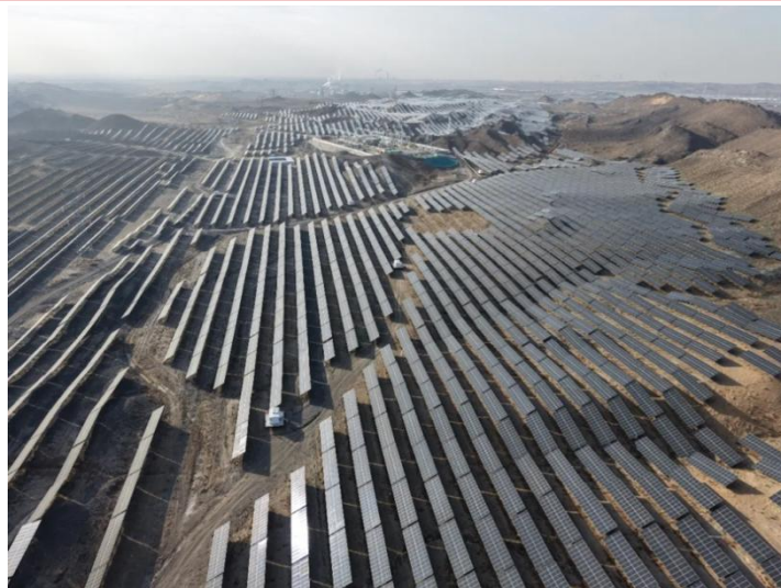
图 17：中国大唐中卫云基地 50 万千瓦光伏电站
