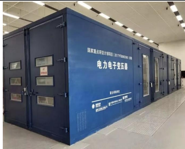
图40、中国西电苏州同里综合服务能源中心的 10kV/3MVA 的 SST
