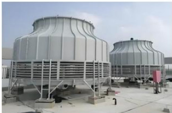
图5: 冷却塔的外观
